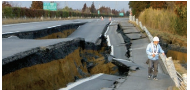
Una sección de 150m de la autopista Joban se hundió en el terremoto. Copyright: Ministry of Foreign Affairs of Japan
